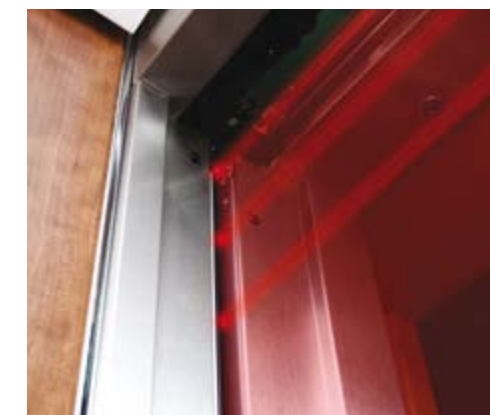
Infrarrojos de cabina
